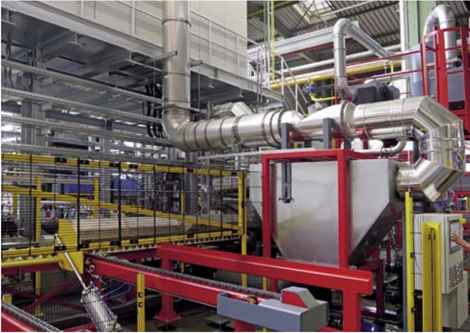
Luft-/Wasser-Wärmetauscher der ESU-Stangenvorwärmung. Das bis zu 90 °C erwärmte Wasser wird drucklos auf die Stangenoberfläche geleitet / The air/water heat exchanger of the ESU log preheating system. The water is heated up to 90 °C and then fed to the log surface without pressure.
