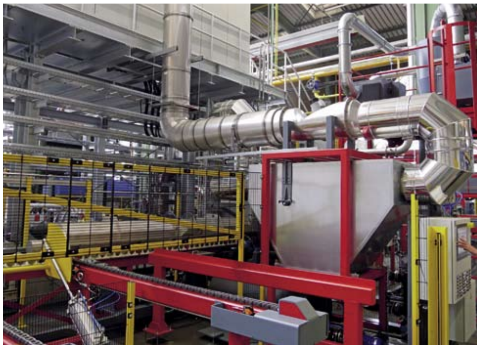
Luft-/Wasser-Wärmetauscher der ESU-Stangenvorwärmung. Das bis zu 90 °C erwärmte Wasser wird drucklos auf die Stangenoberfläche geleitet. / The air/water heat exchanger of the ESU log preheating system. The water is heated to up to 90 °C and is then fed to the log surface at atmospheric pressure.
