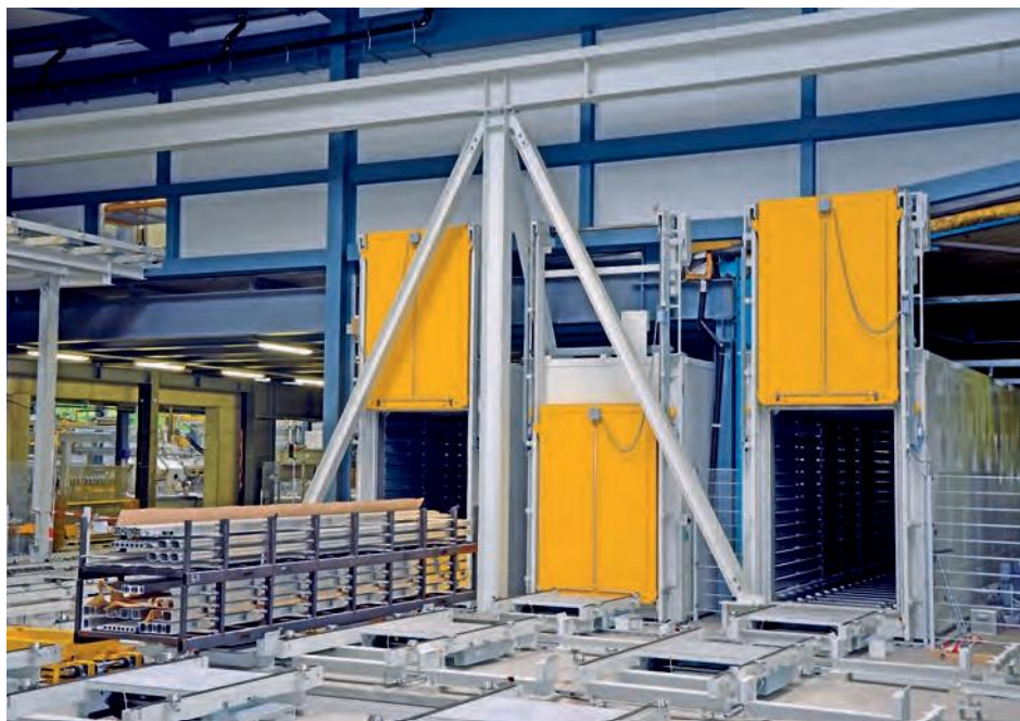
Bei der Auslegung der Auslagerungsöfen kommt es aus Sicht des Energiebedarfs auf gute Isolierung und optimierte Luftführung im Ofen an
