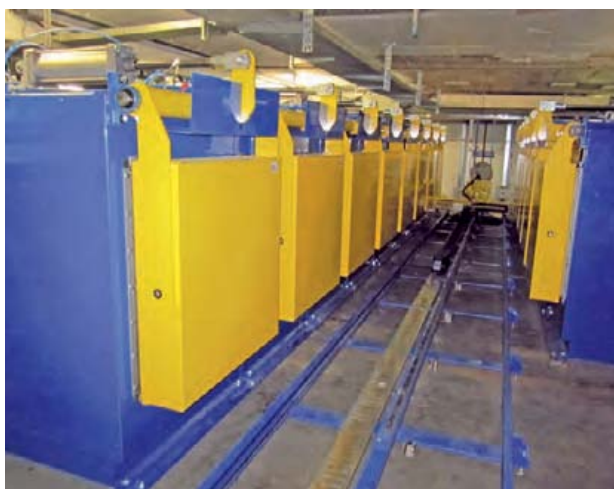
Werkzeugöfen mit Beschickungseinrichtung Die heating furnace with loading device
