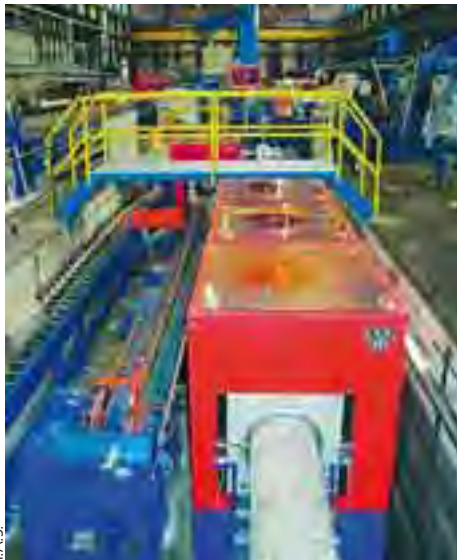
Kombinierte Induktionsofenanlage mit induktiver Vorerwärmung und anschließender induktiver Feineinstellung der Bolzentemperatur
